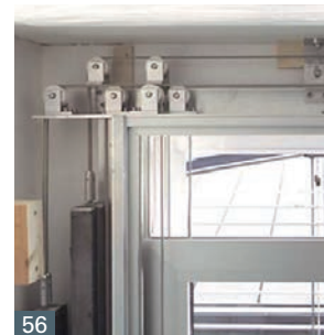
Abb. 56 Aufhängung der Bleigewichte und versetzt angeordnete Rollenpaare zur Führung der Edelstahlseile im Sturzbereich.
