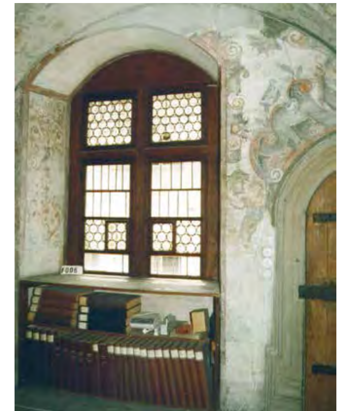
Abb. 1.25: Überlingen, Münsterplatz 8, Stadtkanzlei, erbaut 1598 bis 1600: Die bauzeitliche Rundscheibenverglasung ist nur noch in Teilbereichen vorhanden. Reparaturverglasungen wurden als Rechteckverglasungen ausgeführt.
