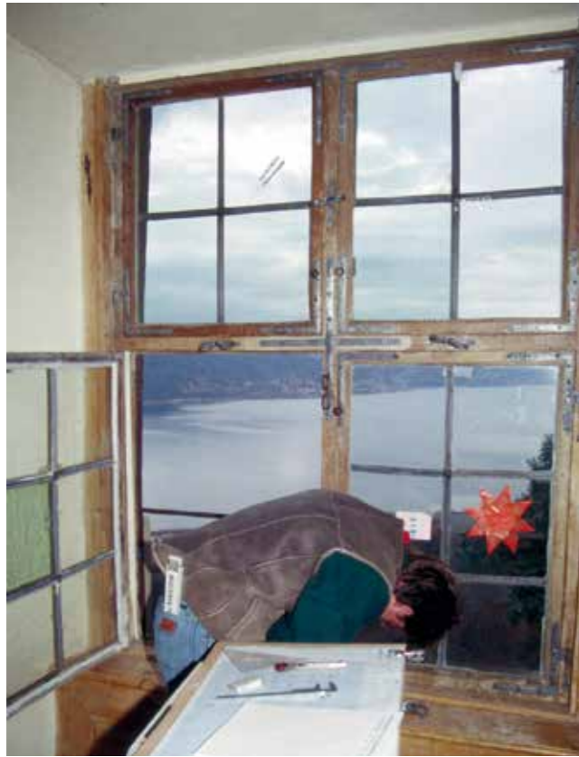
Abb. 1.26: Bodman, Kloster Frauenberg, erbaut 1611: Verglasung und Binnengliederung des bauzeitlichen Fensters wurden barockisiert. Im unteren Flügel waren ursprünglich zusätzliche Lüftungsschieber angeordnet.
