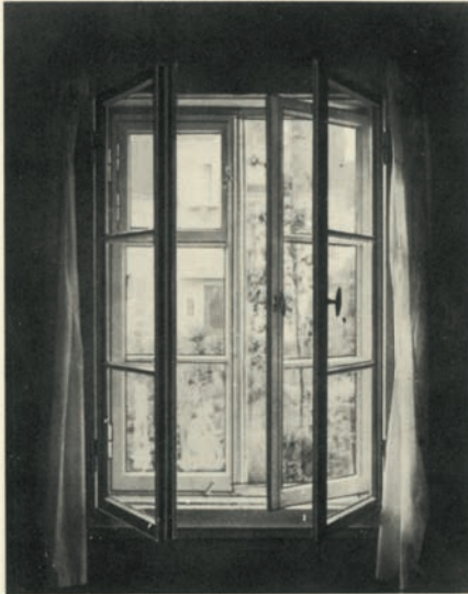
Anschluß des Fensters in einem Holzfachwerkbau. Zu beachten sind die genau durchdachten Einzelheiten, z. B. Maueranschlag, Putzanschlüsse und Anschlag des Ladens
